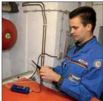
Heizkessel, die älter als 30 Jahre sind, müssen ausgetauscht werden. Foto: ZVSHK/txn
